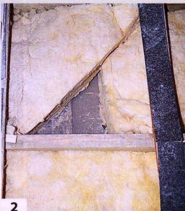
2 Ранее уложенную минеральную вату не вынимали (поскольку она имеет хорошие и тепло- и звукоизоляционные свойства), а устранили недостатки ее укладки. В легком деревянном перекрытии она существенно улучшит звукоизоляцию
