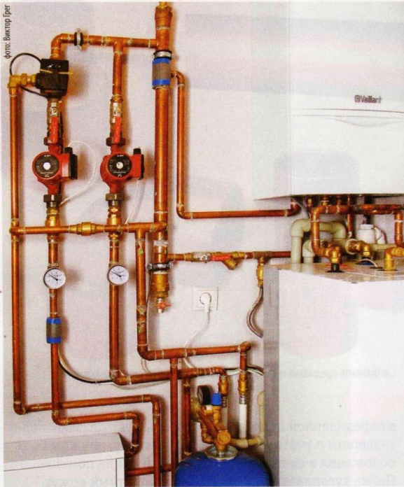
Обвязку отопительного котла очень часто выполняют из медных труб
