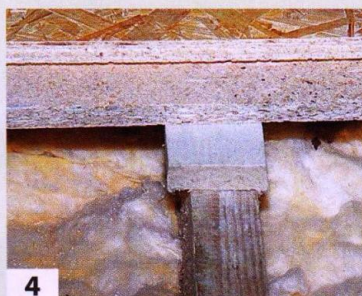
4 Для обеспечения горизонтальности укладки последующих слоев пола на балки перекрытия в нужных местах приклеены полосы резиново-пробковой подложки (резина, смешанная с прессованной пробкой), поверх них уложены полосы из войлока. На это подготовленное основание уложены OSB-плиты
