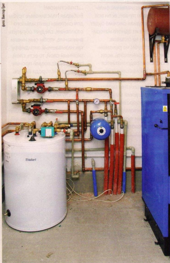
Систему в котельной и основные ветки системы отопления часто выполняют из медных труб. Металлопластиковые трубы широко используются для подводки системы к отдельным теплоприемникам (радиаторам), а также в системах холодного и горячего водоснабжения
