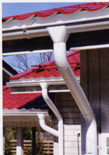
↑ Современные водосточные системы представляют собой полный комплект элементов, позволяющих отвести воду с крыши самой сложной конфигурации
