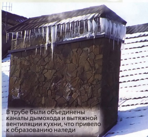
Плохая изоляция трубы стала причиной появления высолов и скопления влаги
