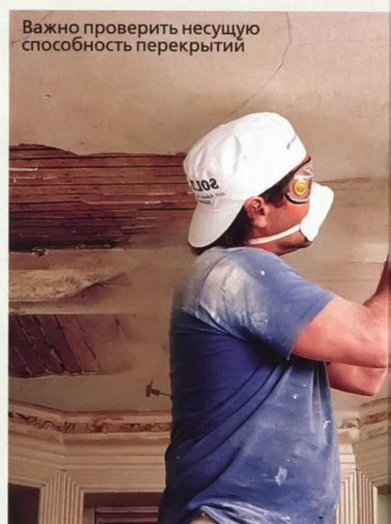
Чтобы обнаружить поврежденные участки конструкций, необходимо вскрыть отделку
