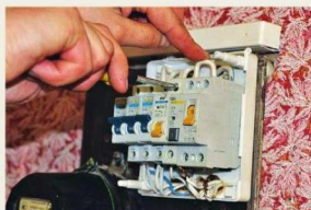
2 Вставляют УЗО. Подключают следующую перемычку на входящий ноль
