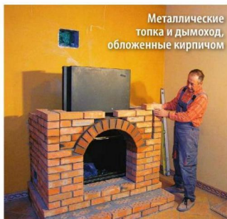
Простой кирпичный камин
