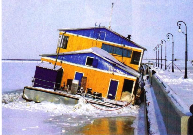
Строение 80-х годов на бетонном понтоне модернизировали, не привлекая профессионального проектировщика, в результате чего нагрузка была распределена неправильно.
