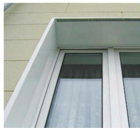
Чем тщательнее отделаны наружные и внутренние откосы оконного проема, тем лучше окно защищено от теплопотерь
