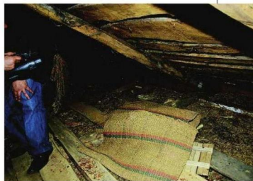
Чтобы выявить место протечки, сначала проверяют состояние стропил в чердачном помещении
