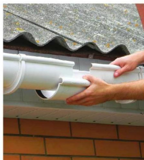
Изношенные уплотнители в секциях водостоков из ПВХ нужно заменять
