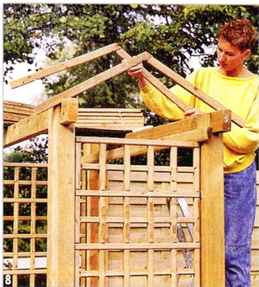
8 В качестве стропил используют доски сечением 20х45 мм. Сначала их собирают на земле в стропильные элементы, которые затем крепят к балкам.
