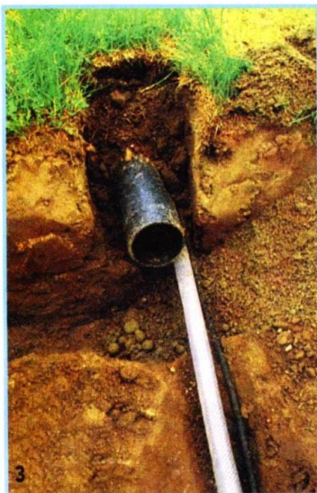
На определённом отрезке ручей течёт под газоном. На выходе воды из-под газона видны проточная труба, труба для перекачки воды и электрокабель.
