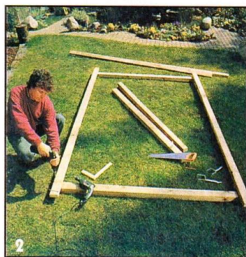
Рамы стен собирают на ровной площадке из трёх стоек и верхней и нижней продольных балок. На нижней продольной балке делают три выреза под анкера.
