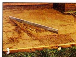
Горизонтальность основания выверяют с помощью длинного уровня или ровной рейки, на которую кладут обычный уровень.
