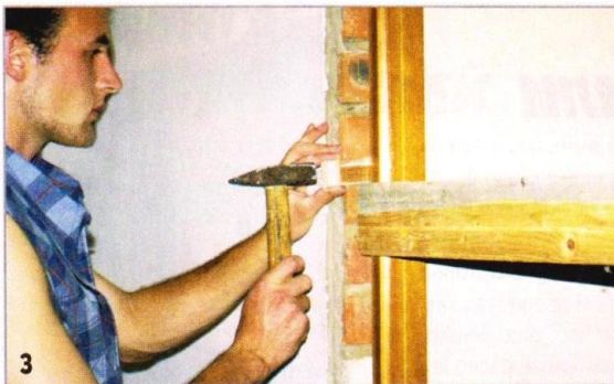
Из обрезков досок и брусков выстрогали 20 клинышков нужных размеров, которыми зафиксировали дверную коробку в проёме, установив их с обеих сторон брусков коробки вблизи распорок.
