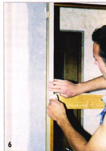
Если не защитить малярной лентой поверхности дверной коробки, попавшую на них монтажную пену трудно будет потом удалить, не повредив отделку.
