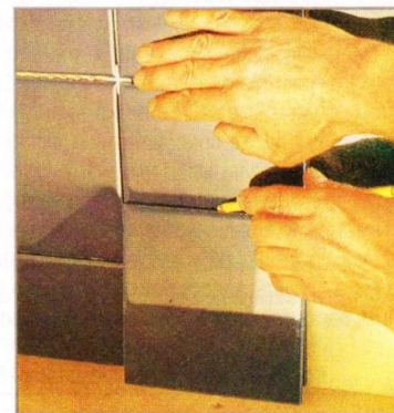
Разметка плиток нижнего ряда. Плитку прикладывают к стене и отмечают маркером линию реза.
