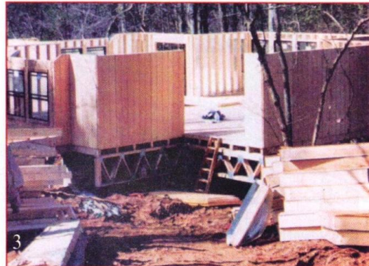
Дом прибыл на место. Изготовленные на заводе конструкции доставили на двух трейлерах. Щитовой дом быстро собирается, монтаж был закончен за три рабочих дня.
