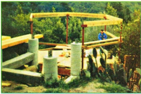
Сваи послужат опорой гаража. На заднем плане угловые стойки из стальных труб несут балки перекрытия сечением 100х300 мм. Фото с точки В на плане дома.
