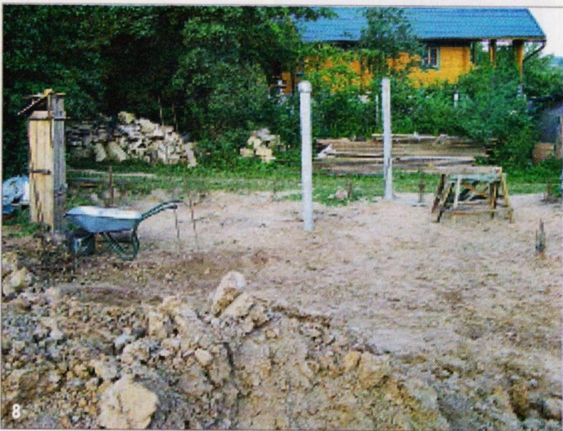
Канализационные стояки на поверхности.
