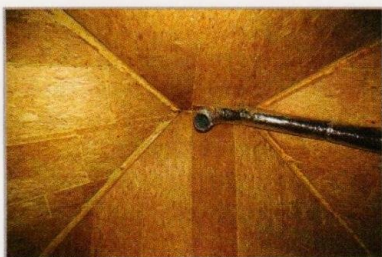
Самая верхняя точка забора воздуха — в коньке крыши.
