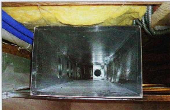
Магистральный воздуховод (вид изнутри).
